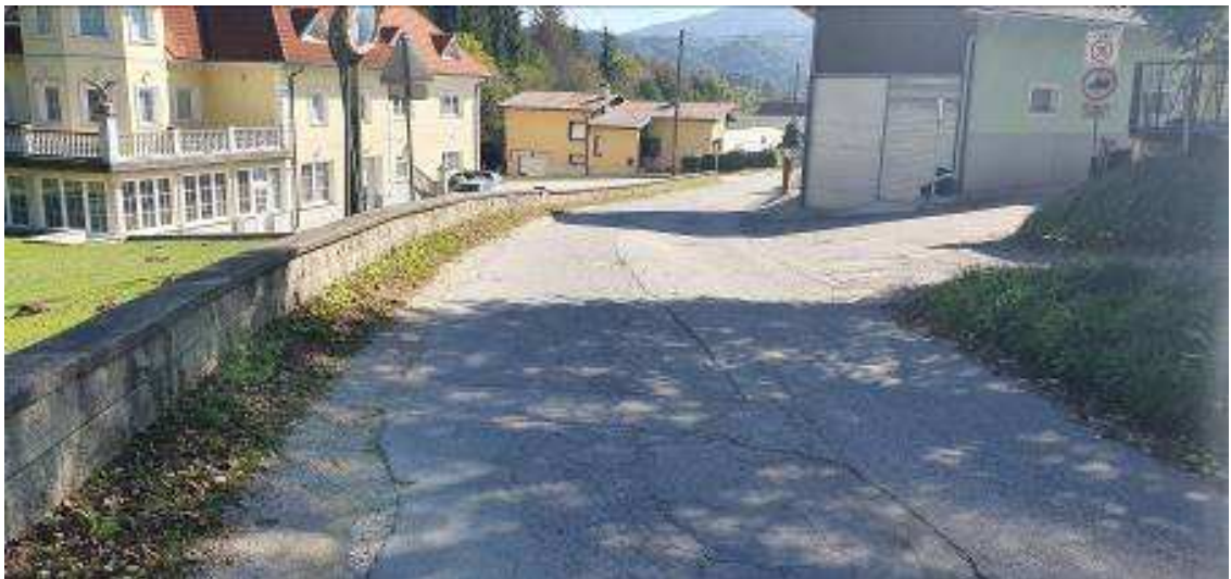
Lokacija zaključka fekalnega kanala 1.2 v cesti R3-8801 Sp. Selnica – Duh na Ostrem vrhu
